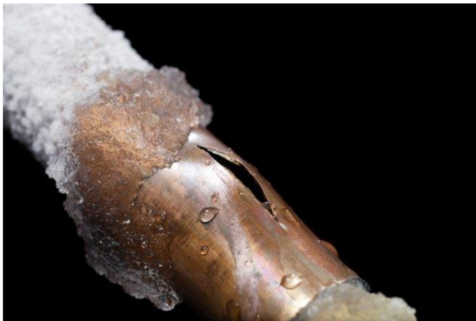
Рисунок 2. Смерзание и разрушение трубопровода Figure 2. Pipeline freezing and collapse
