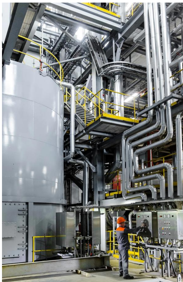
Рисунок 2. Корьевой котел ТЭЦ АО «СЛПК»
